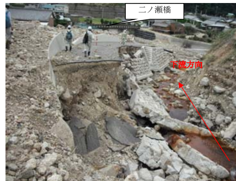
砂防堰堤下流の破壊された道路・擁壁(遠方に見えるのは二ノ瀬橋)
