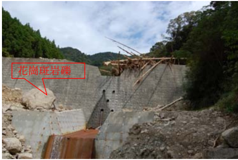
支沢b砂防堰堤の流木堆積状況(手前は堰堤を越えた花崗斑岩の巨礫)
