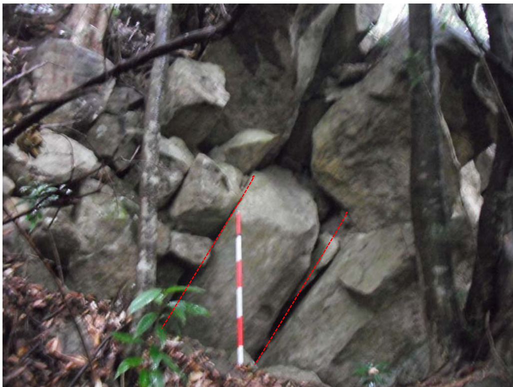
兒子ヶ原地区崩壊の上方斜面に見られる浮石(節理沿いに分離)
